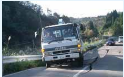
被災地に向かって陥没した道路を進む先発隊(新潟県)
